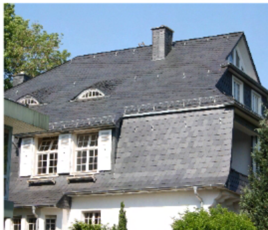
Deutsche Deckung mit Bogenschnittschelonen an Dach und Mansarde eines Geschäftshauses in Bielefeld
